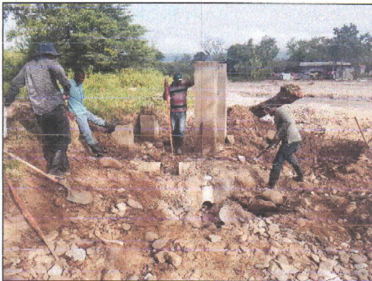
ACTIVIDAD. – (Repacion de tubería P.V.C de 10 pulgadas en línea que conduce hacia las Colonias, Reino Unido, Rafael Diaz Chavez, Porfirio Martinez y Santa Lucía)
