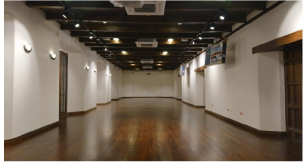
Acabados en interiores finalizados y sistemas de climatización e iluminación probados y funcionando según Especificaciones técnicas del proyecto.
