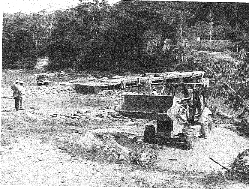
Figura 2 y 3. Construcción de Vado sobre el rio Cuyamel, Catacamas Departamento de Olancho
