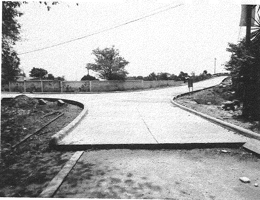
Figura 15. Pavimentación con concreto hidráulico de entrada al Municipio de San Isidro, Departamento de Intibucá.
