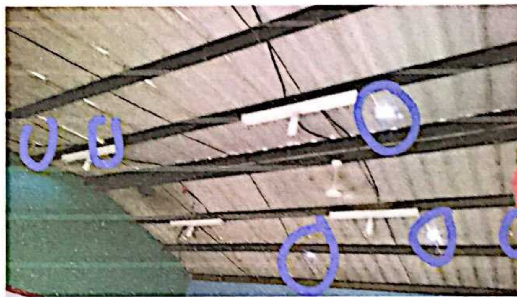
AULA Nº 2 DAÑOS MARCADOS
