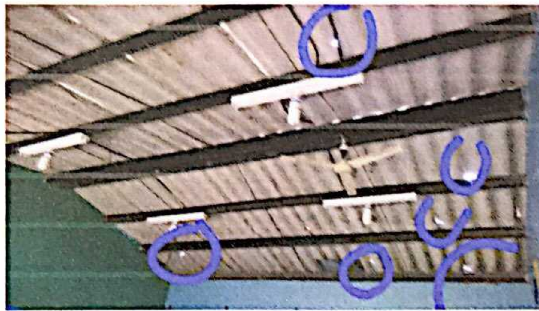
AULA Nº 3 DAÑOS MARCADOS
