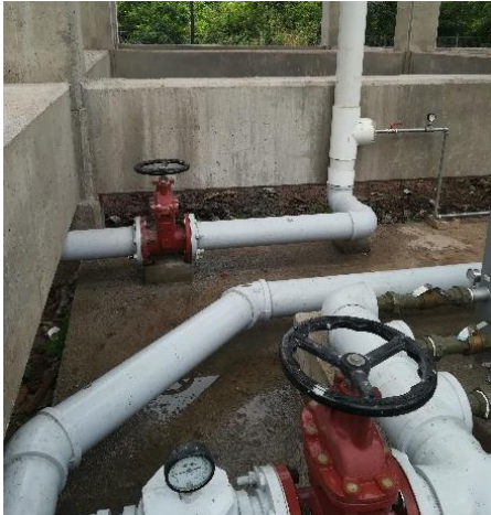
Sistema de Bombeo
