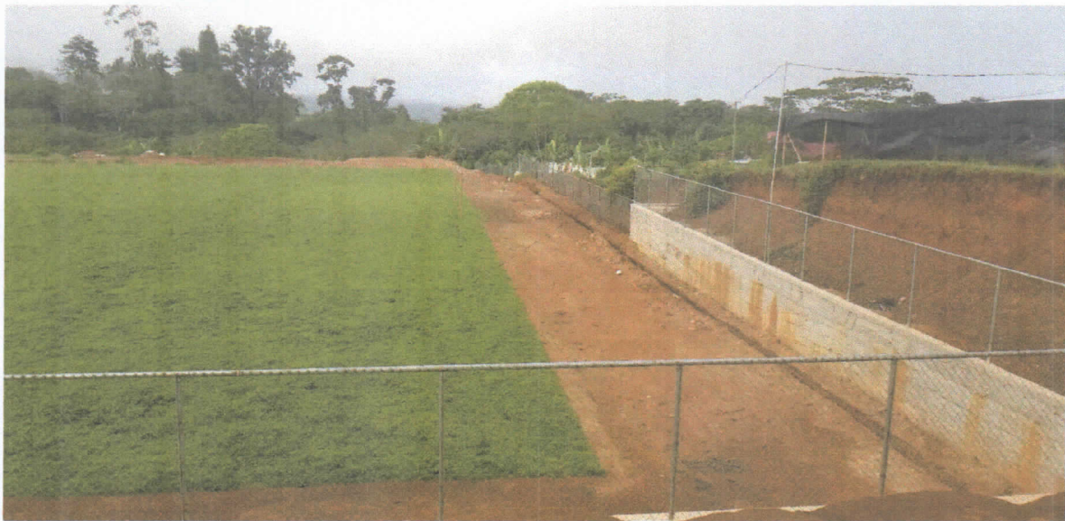
CERCO DE MALLA CICLON Y TUBO GALVANIZADO
