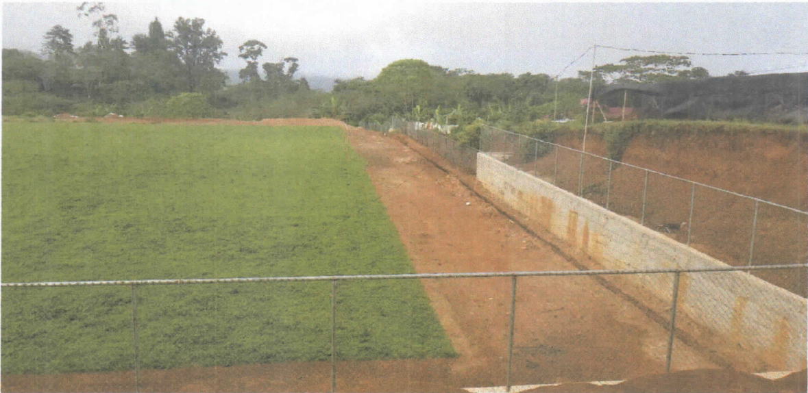
CERCO DE MALLA CICLON Y TUBO GALVANIZADO
