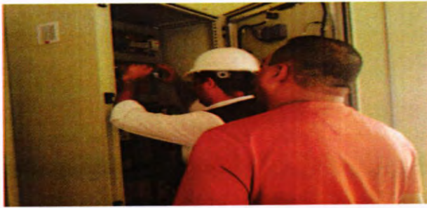
SISTEMA DE AUTOMATIZACION Y PRUEBA DE FUNCIONAMIENTO
