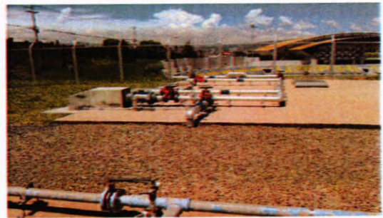
TREN DE DESCARGA SISTEMA DE BOMBEO EN PRUEBA DE FUNCIONAMIENTO
