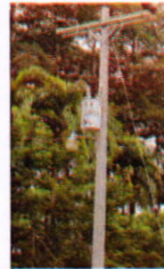
Vista de poste de concreto de 40 pies y transformador de 25 kva; 01-11-2017
