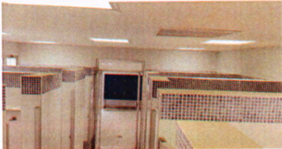
Vista de duchas de varones en Módulo de Desinfección Personal (30-10-2017)
