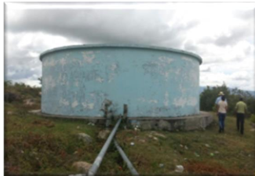
Proyecto de agua potable Morocelí.
