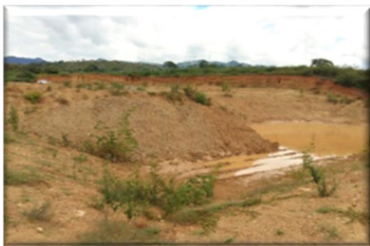
Proyecto de agua potable Morocelí.
