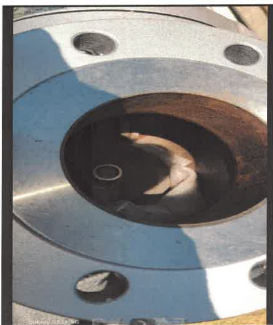
1 VALVULA DE 4" CHECK HORIZONTAL
