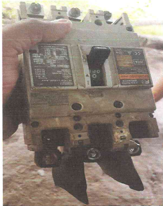
Cambio brake dañado
