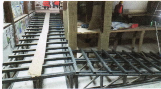
Rampa metalica de acceso a nivel de salas de estudio de grabacion.
