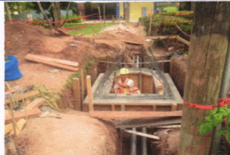
Caja eléctrica fundada, línea de media tensión
