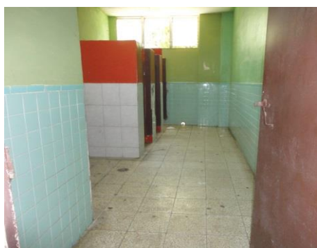
Servicio sanitario de mujeres en Edificio No.1
