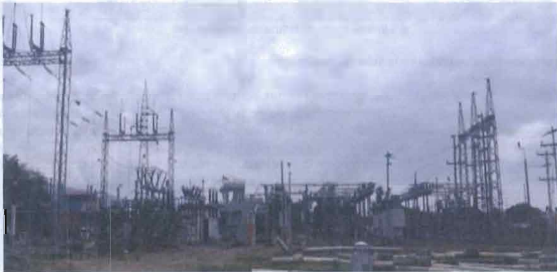
Imagen 3. Vista panorámica de la Subestación Comayagua
