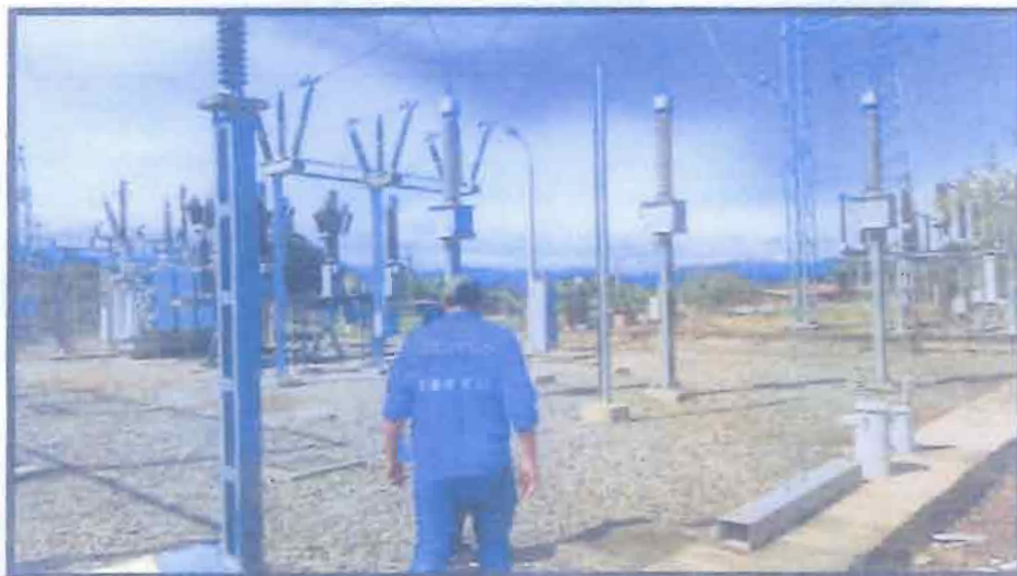
Ilustración No. 2: Instalaciones de la sub estación.
