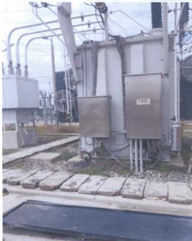
Imagen 6. Transformador de potencia instalado en subestación Comayagua
