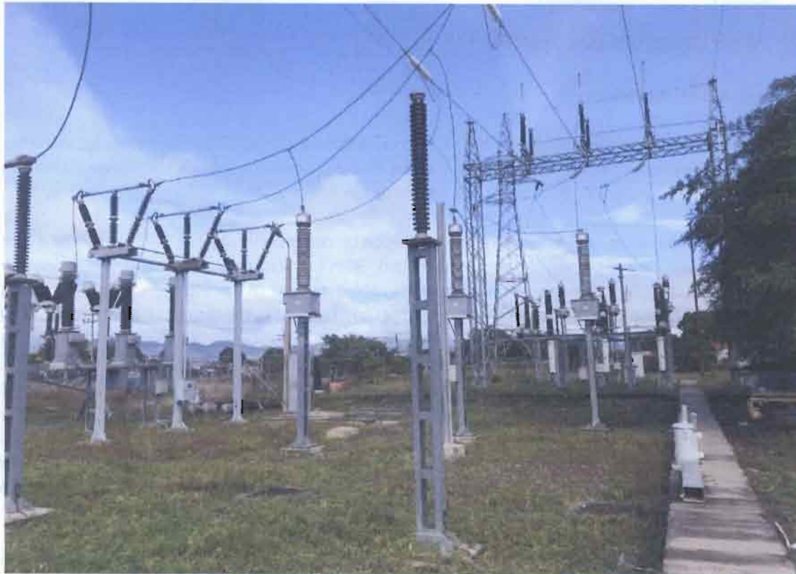
Imagen 4. Área de la Subestación Comayagua
