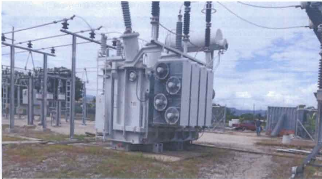
Imagen 5. Transformador de potencia instalado en la subestación Comayagua
