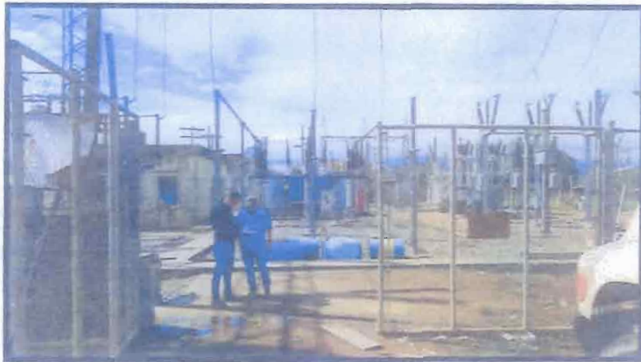
Ilustración No. 1: Sub estación eléctrica Comavagua 138/34.5kv
