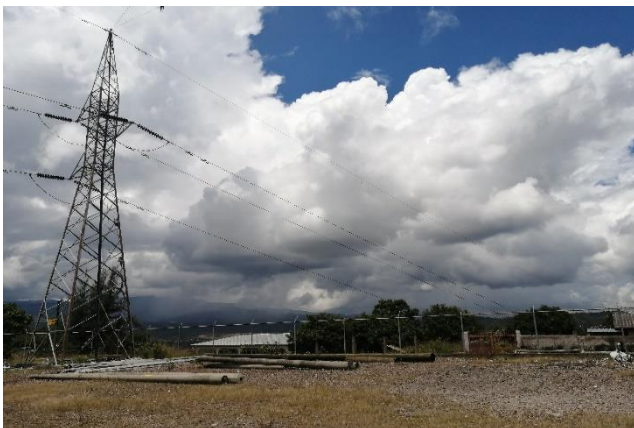
Imagen 5: L550 proveniente de la SE Cañaveral, viviendas se ubican en el área de servidumbre.
