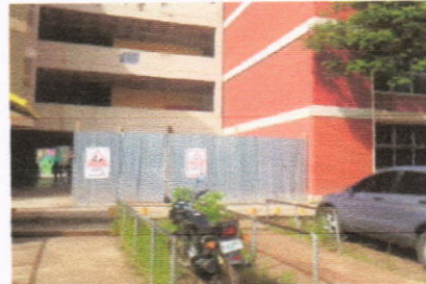
Cerco para cubo de elevador, edificio D1
