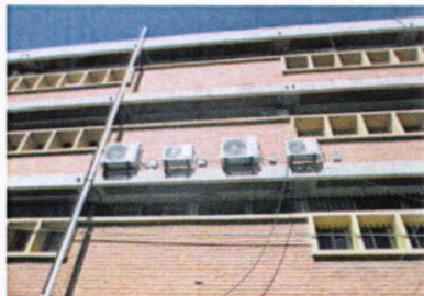
Vista de condensadores de aire acondicionado ubicados en el exterior del edificio J-1
