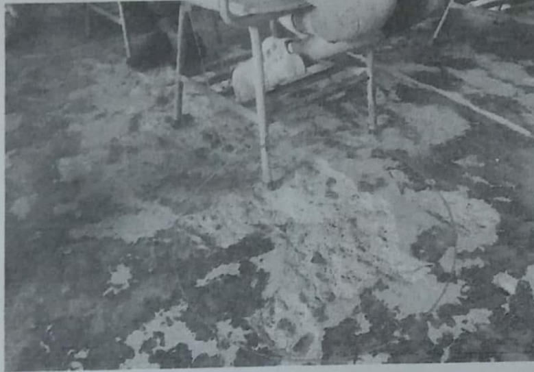
Piso con grietas, en pésimo estado
