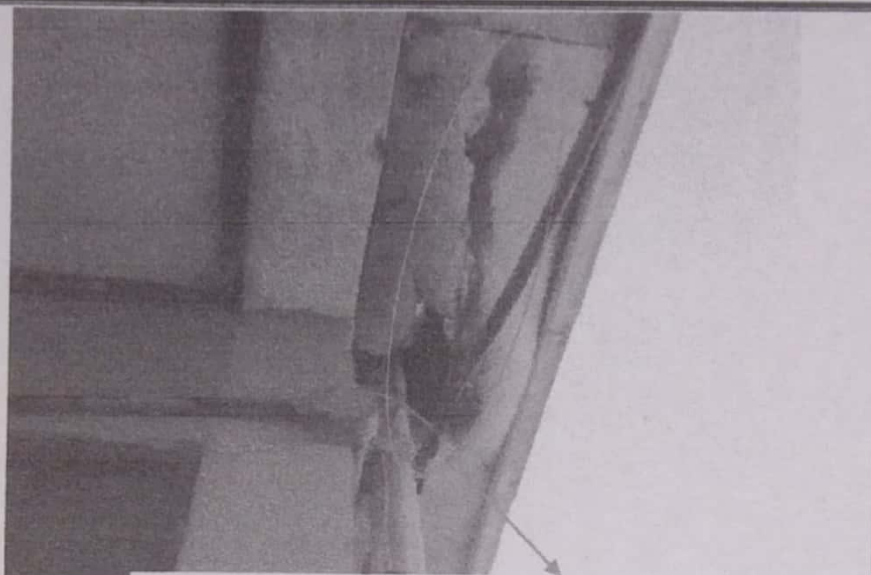
El cielo raso, presenta agujeros, está en muy mal estado
