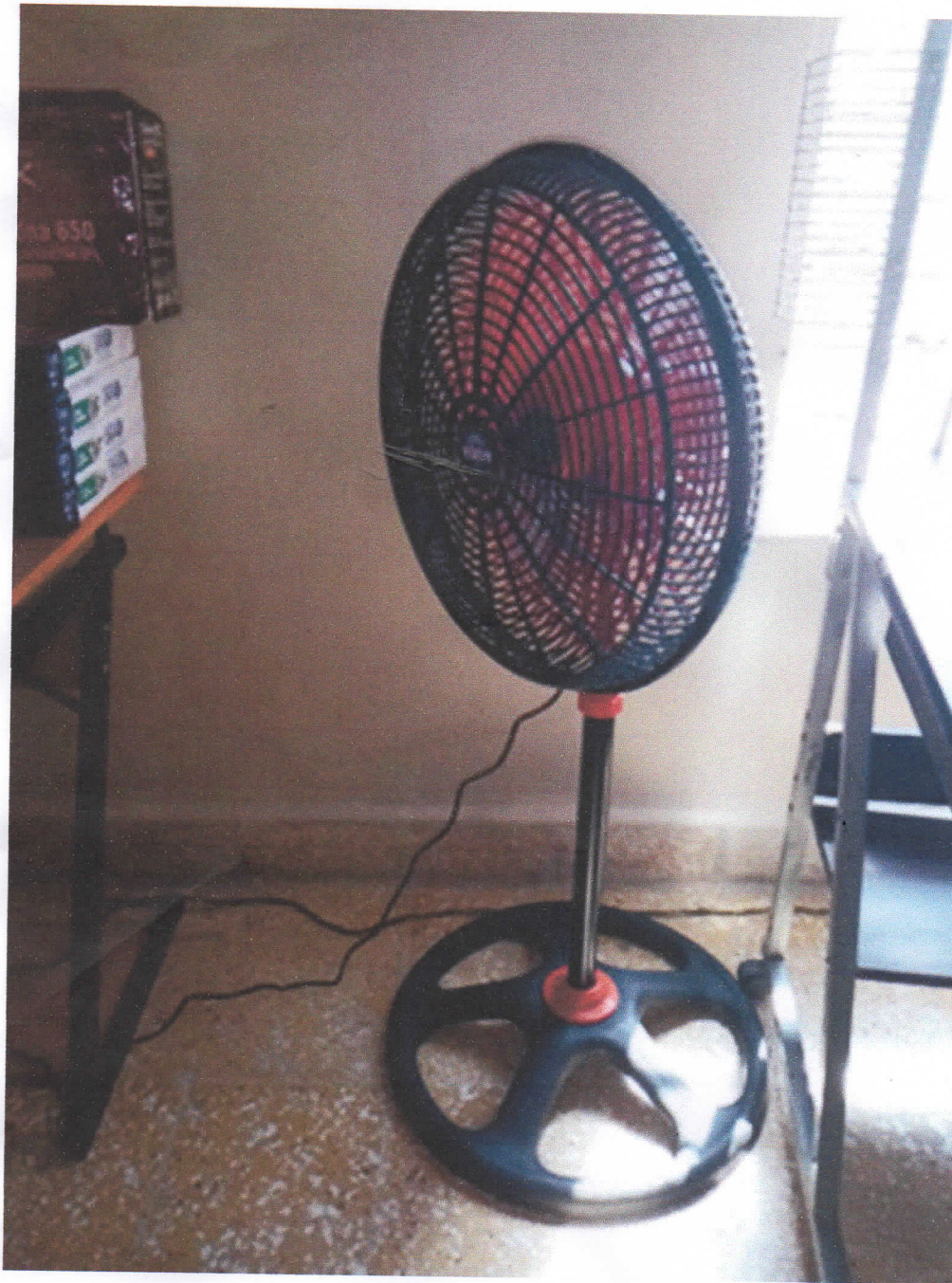
Ventilador de la Unidad de Artes, Cultura y Deportes
