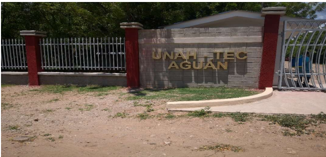
No 3.- Letras encajueladas en pared del muro perimetral
